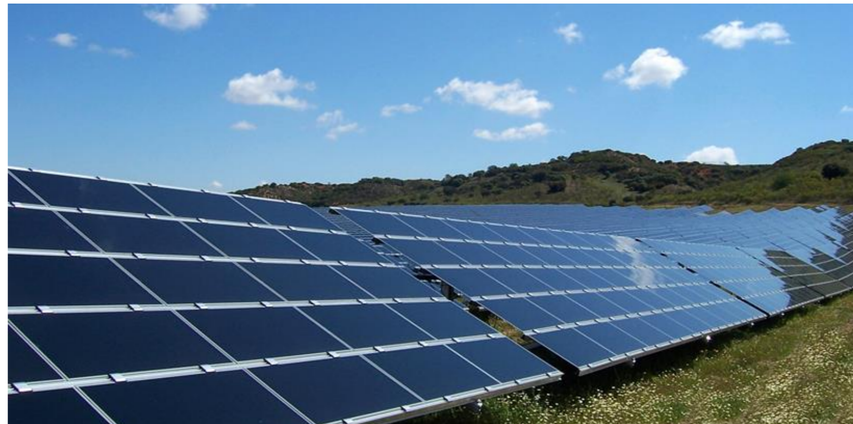
Parc photovoltaïque EDF Renewables de Narbonne
